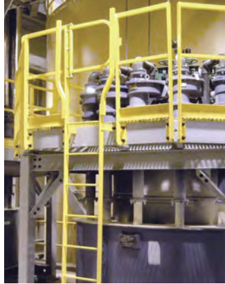
Plataforma elevada con guardarriel de protección.
